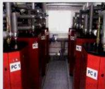
Fot. 1. Widok ogólny pomp ciepła Stacji Uzdatniania Wody w Białej Podlaskiej
