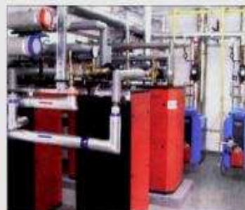
Fot. 2. Widok instalacji pomp ciepła Stacji Uzdatniania Wody w Białej Podlaskiej
